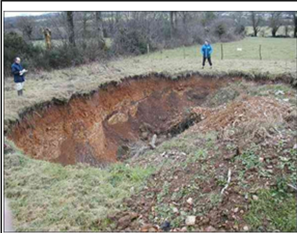
Fontis : apparition d'un cratère d'effondrement remontant des vides souterrains
